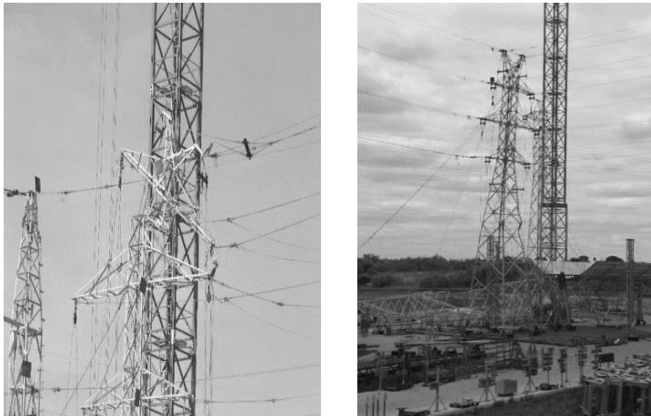
Rys. 6. Schematy zniszczenia słupów dwutorowych EN122 [7]
