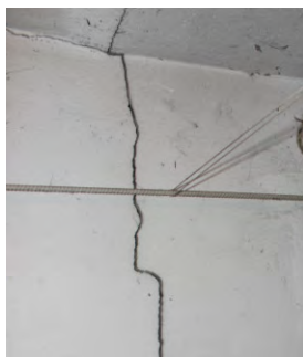
Rys. 3. Pęknięcia ścian zewnętrznych
