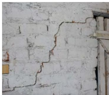
Rys. 4. Pęknięcia piwnicznych ścian działowych
