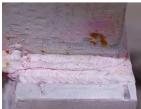
Rys. 4. Nieciągłości w spoinie pachwinowej ujawnione metodą penetracyjną
